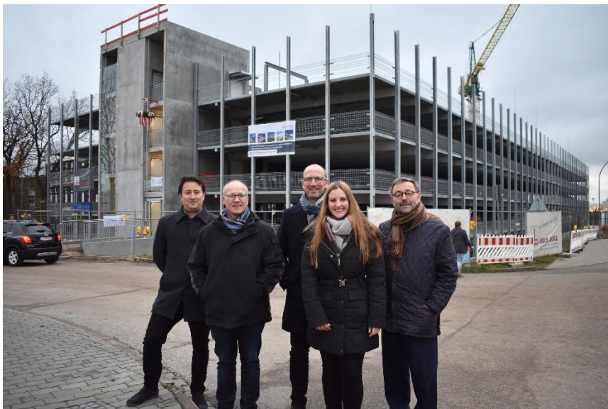
Vor dem Parkhaus (v.li.) Immanuel Mihm und Cristian Koch von Schnittger Architekten + Partner, Werner Christiansen, technischer Leiter des Klinikums, Lena Hagelauer, Projektleiterin bei der Firma Max Bögl und Krankenhausdirektor Bernhard Ziegler.
